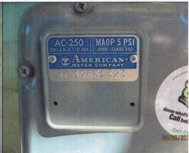
M Sanders 040610 - gas meter
