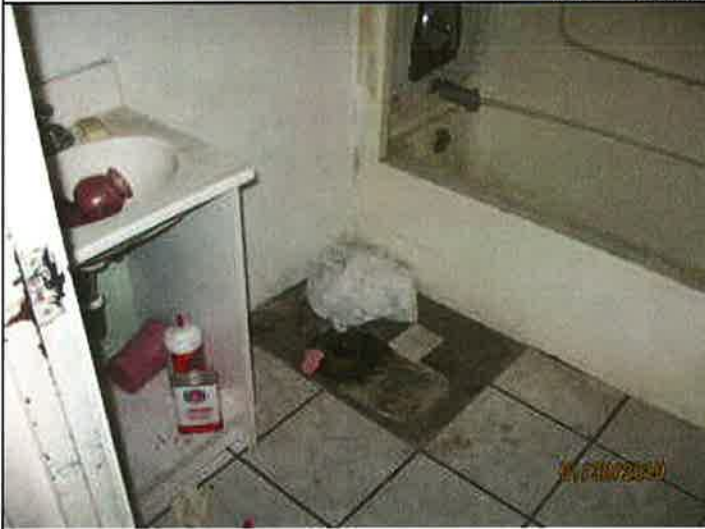
Missing toilet. RHannah NOD 14,17
