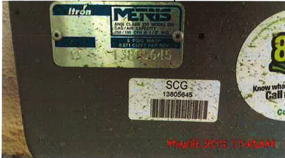
E. Torres; gas meter - 05/05/2015
